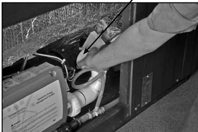
... a pumpa csatlakozásánál
