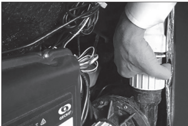
... a pumpa csatlakozásánál
