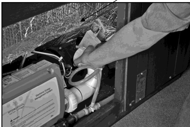
... A PUMPA CSATLAKOZÁSÁNÁL
