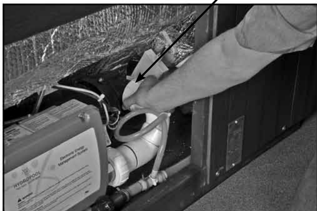
... a pumpa csatlakozásánál
