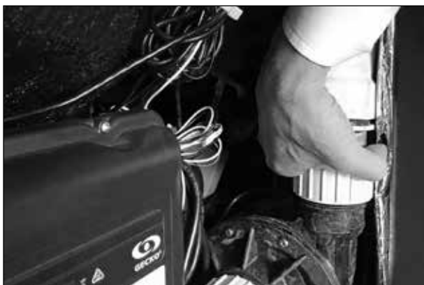
... a pumpa csatlakozásánál
