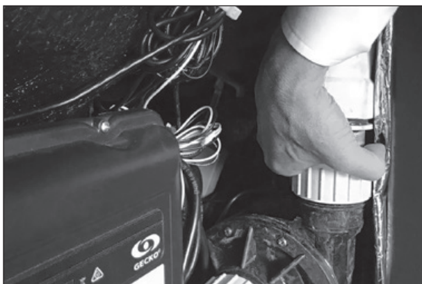
... a pumpa csatlakozásánál
